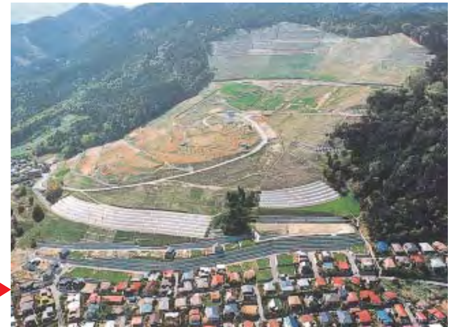
地すべり対策工事によって安全な土地へと姿を変えました。(平成2年6月撮影) Landslide prevention works have made this area safe. (Photo taken in June 1990)
